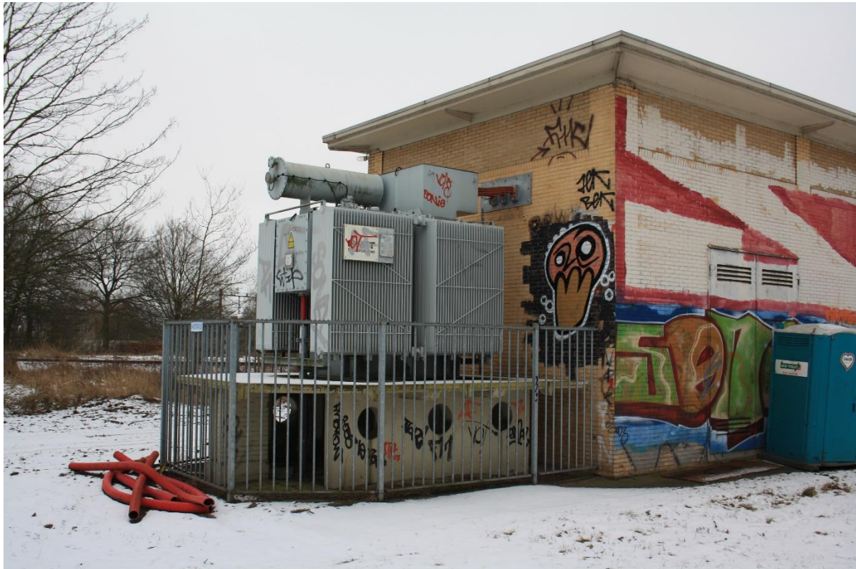
Figuur 24: Transformator met technische ruimte
