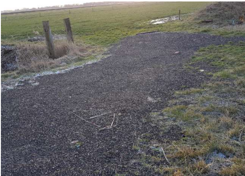
Dam 28: Puin / asfaltverharding
