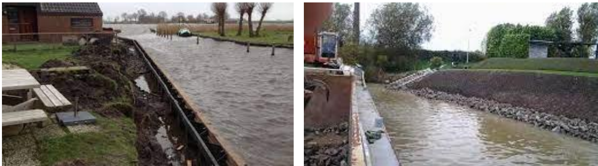
Figuur 2: Links het plaatsen van een damwand, rechts onderwaterdamwand met daar bovenop in het talud breuksteen
