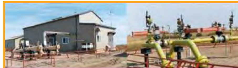
Figuur 3.8: Een CO 2 -verzamel- en -injectielocatie.
