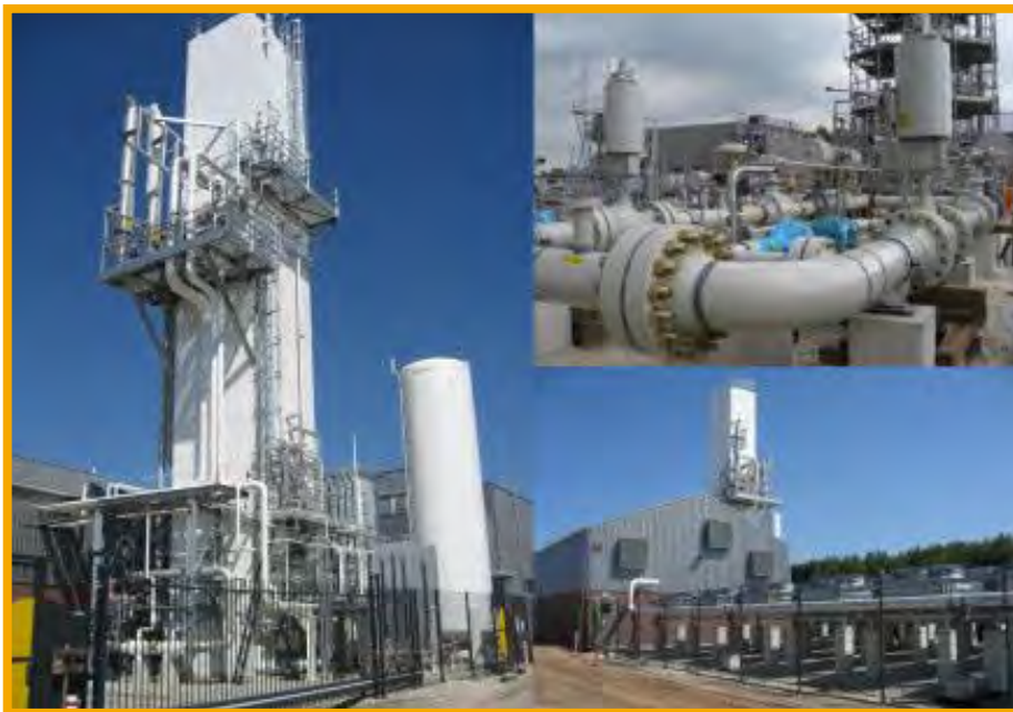
Figuur 3.11. De luchtscheiding- en menginstallaties bij Zuidbroek ten behoeve van stikstofbuffer bij Heiligerlee.
